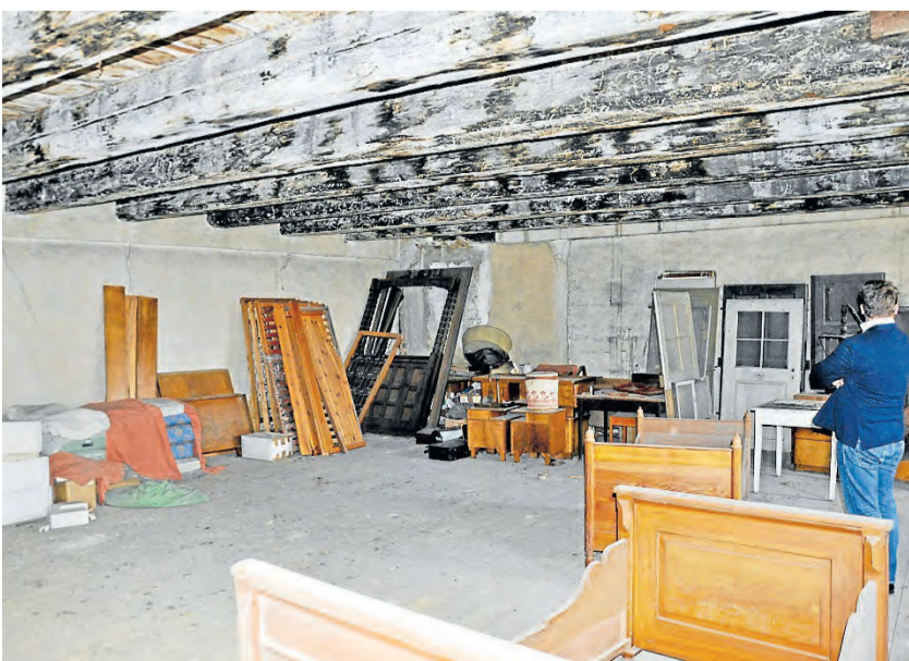
Alte Balken: Das Haus hat Charme, aber es ist noch viel zu tun.
