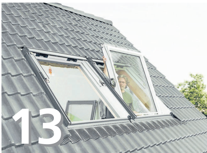
Dachfenster sollte man nach 25 Jahren tauschen.
