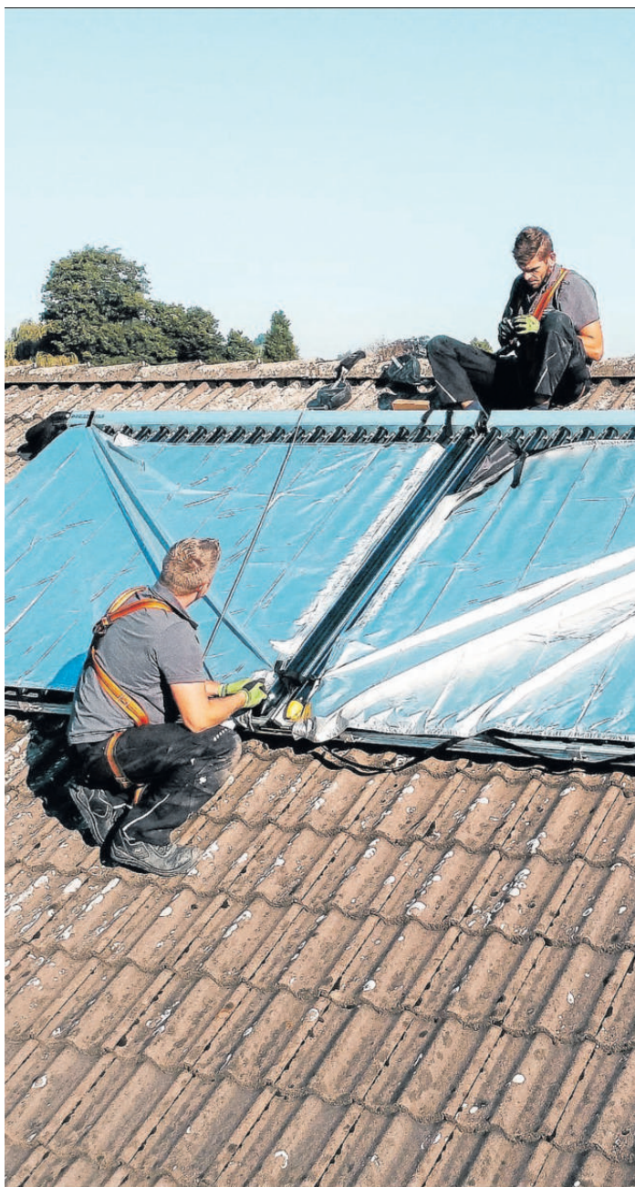
Empfehlenswerte Kombination: Das Solarsystem erwärmt Brauchwasser im Sommer und unterstützt im Winter die Pelletheizung. So lassen sich auch Altbauten kostengünstig mit Wärme versorgen. Foto: DEPI
